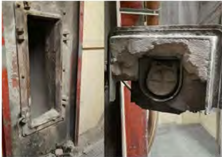
Les bonbonnes peuvent provoquer d'importants dégâts, comme ici l'explosion de la porte du four dans un centre d'incinération de la Vallée de Chevreuse (Essonne).
